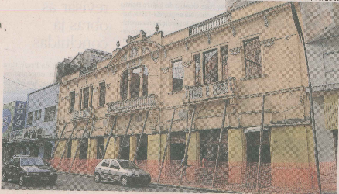
SEM PASSAGEM. A fachada da Strauch ainda está protegida por escoras, e a calçada, interditada
