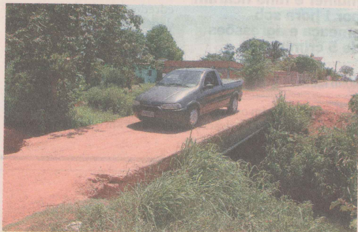
BURACOS. A ponte na Rua Caiçara está em péssimas condições
