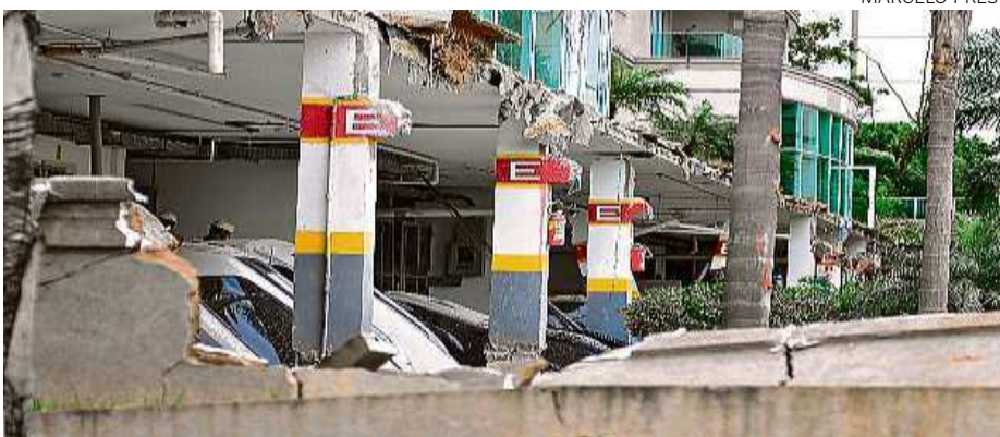
Área da garagem do condomínio foi danificada pelo desabamento
