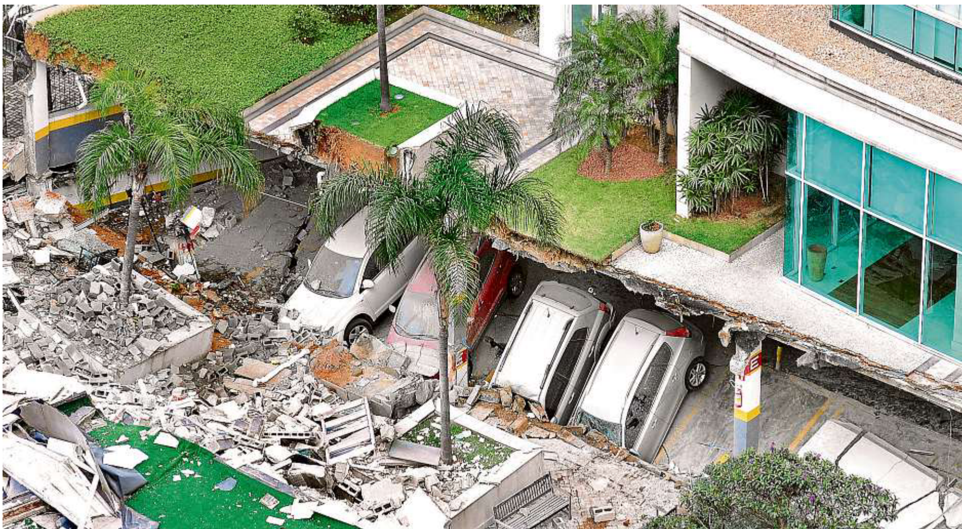
A área da piscina do condomínio de luxo Grand Parc desabou sobre os dois pavimentos de garagem, onde estavam cerca de 300 carros. O porteiro do prédio morreu
