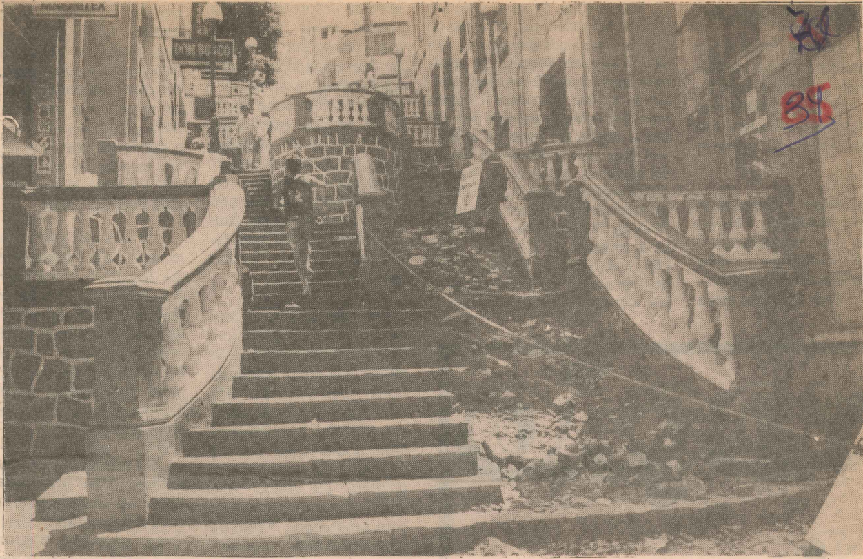
As obras de recuperação da escadaria estão paralisadas e os comerciantes reclamam do entulho amontoado
