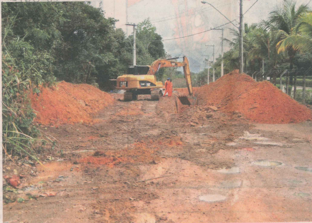
A AVENIDA Ipê, em Manguinhos, na Serra, está intransitável, cheia de lama e buracos
