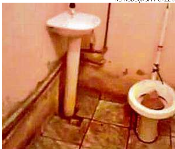
Banheiro precário que era usado pelos trabalhadores
