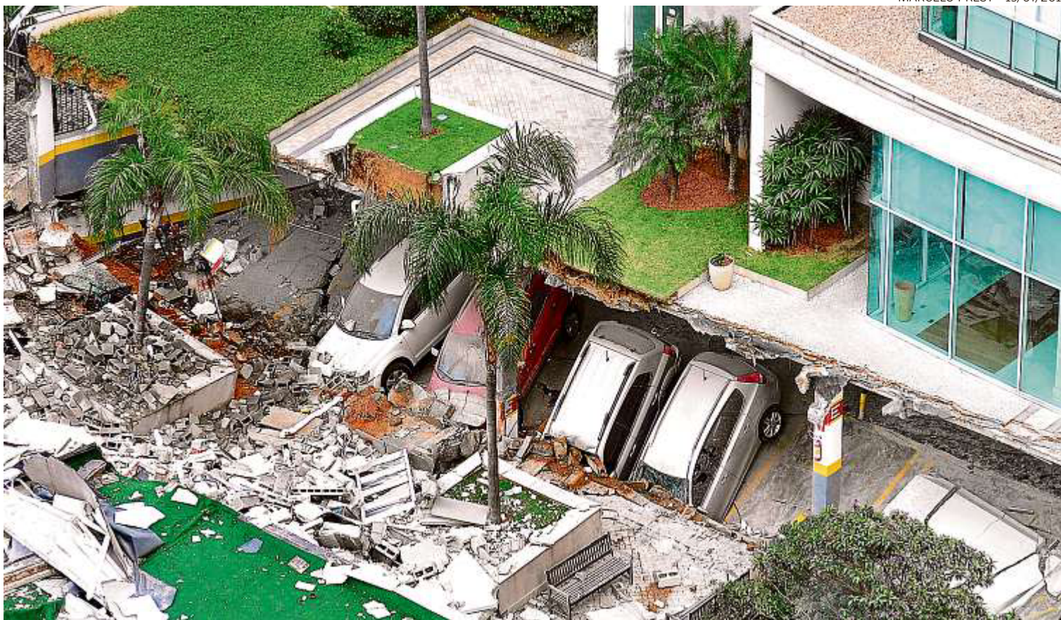
A área de lazer do Grand Parc, na Enseada do Suá, desabou sobre a garagem do local e soterrou 300 carros dos moradores
