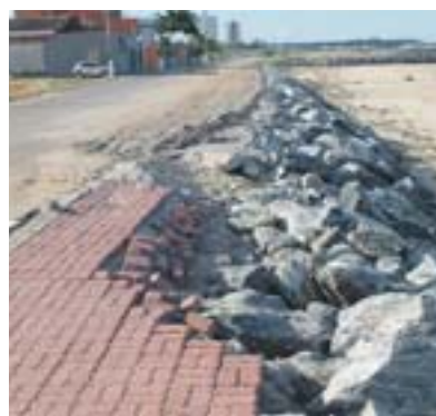
CALÇADÃO danificado pelo mar
