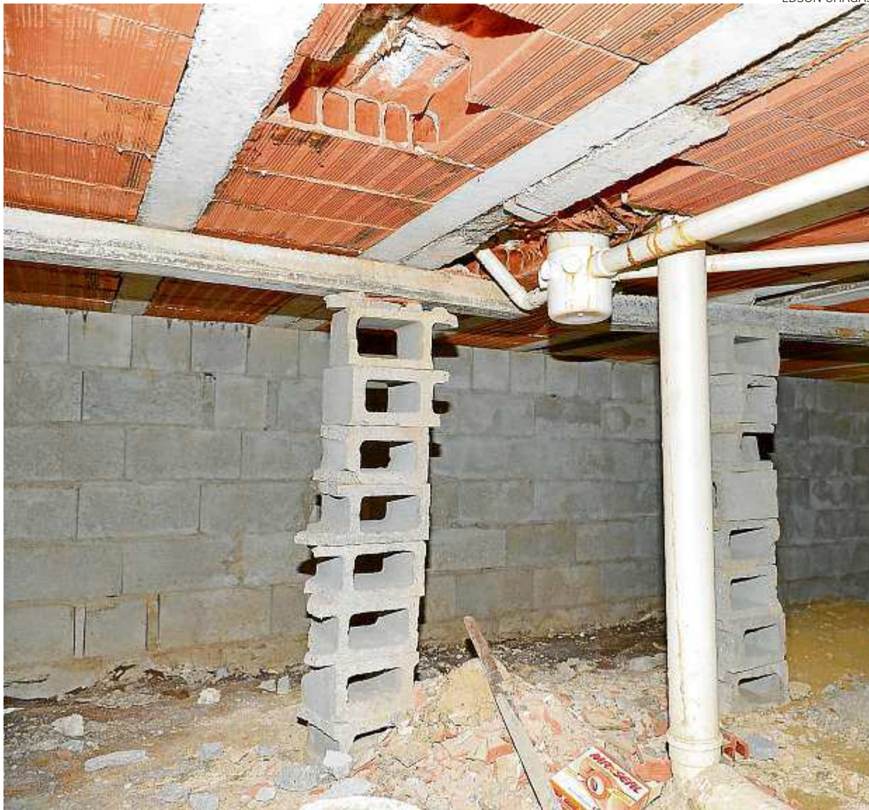
Colunas improvisadas com bloco “seguram” uma viga embaixo do primeiro piso do prédio interditado
