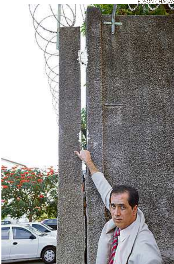
O advogado Fábio mostra a situação precária dos muros
