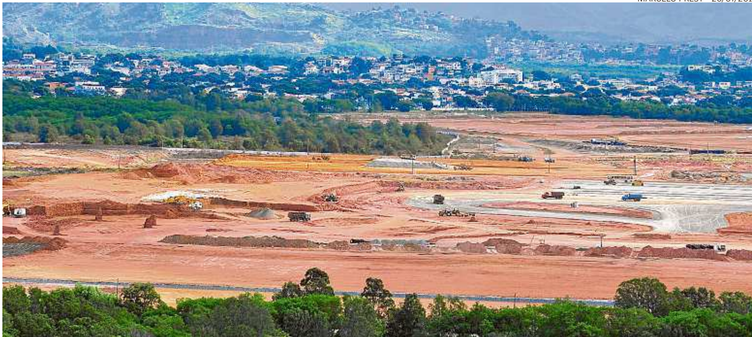
Obras no Aeroporto de Vitória estão na fase de drenagem, pavimentação de parte da nova pista de pouso e aterros complementares
