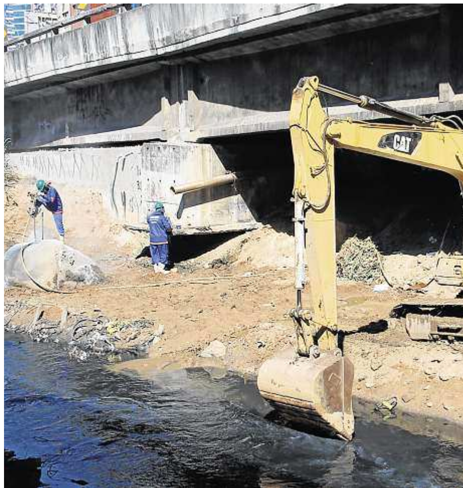
LIMPEZA e retirada de pedras no Canal da Costa: ações para facilitar o escoamento da água no município
