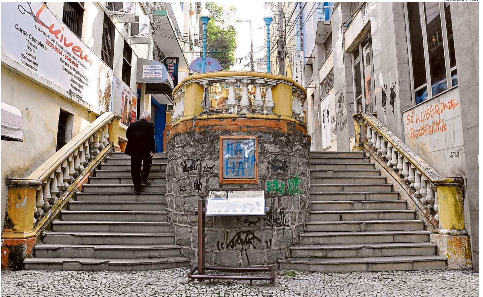
A escadaria Maria Ortiz é um dos pontos históricos do Centro de Vitória que sofrem com as más condições de conservação: partes da estrutura e dos degraus estão quebradas
