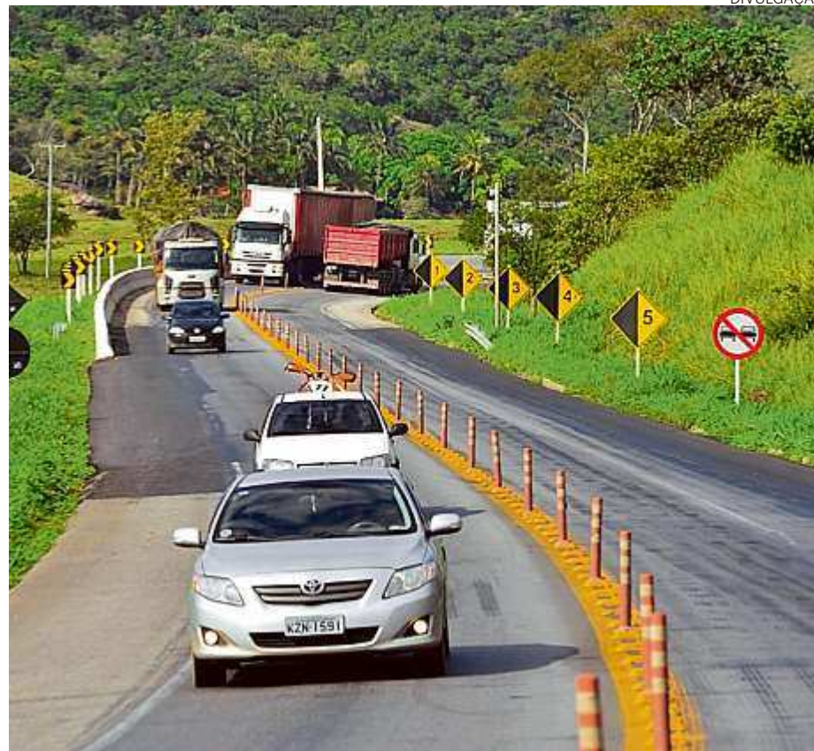
O trecho da 101 que passa por Guarapari faz parte das próximas etapas de obras
