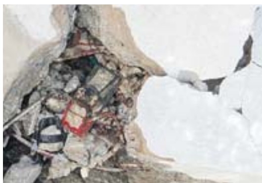
A ANCORAGEM (fixação de elementos estruturais) e a armação de ferro (estrutura para segurar o concreto) na parte da frente do empreendimento estava com vários pontos apresentando excesso de ferrugem, o que pode ter colaborado para o desabamento, segundo o documento.
