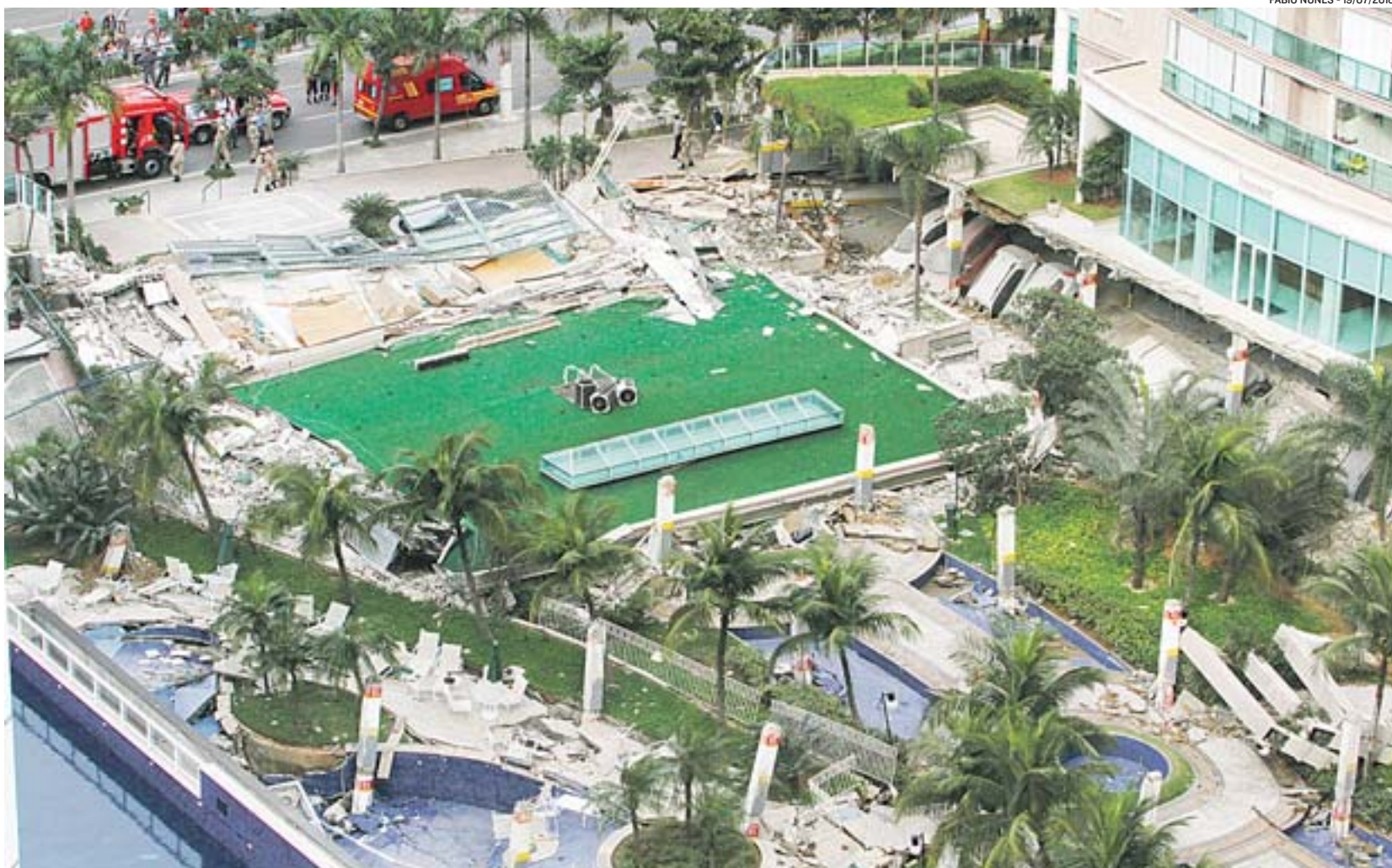
ÁREA DE LAZER do condomínio Grand Parc, na Enseada do Suá, desabou dia 19 de julho, causando a morte de uma pessoa e deixando outras quatro feridas
