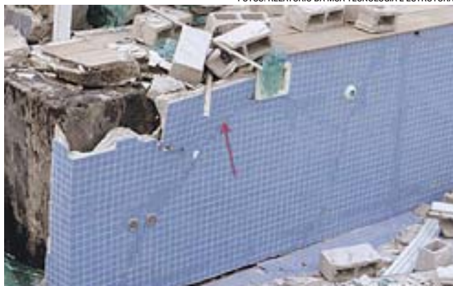
A ESTRUTURA da piscina apresentava marcas de trincas com reparos, que já seriam existentes antes do desabamento, segundo o relatório. O documento diz que era preciso reparo imediatamente após o surgimento da primeira rachadura.
