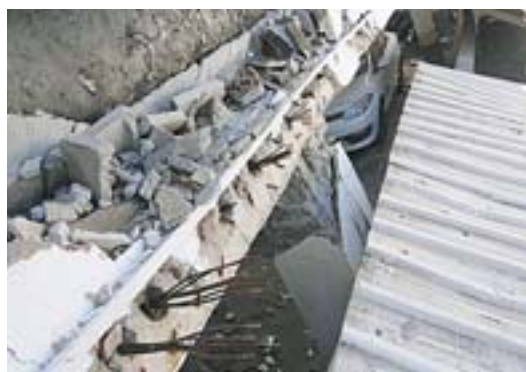
CABOS DE FEIXE que passavam pela piscina já estavam rompidos antes do desabamento da laje, de acordo com os levantamentos apontados no relatório realizado pela MCA Tecnologia e Estruturas.
