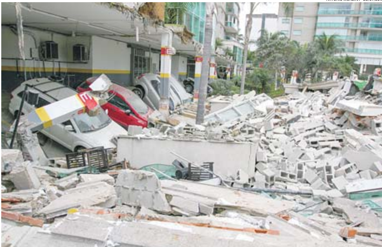
ESCOMBROS da área de lazer de condomínio: perícia judicial ainda está sendo realizada no local do desabamento
