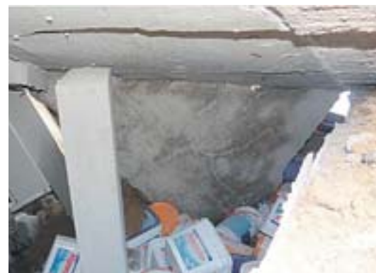
GALÕES DE CLORO e outros materiais nocivos ao concreto foram encontrados armazenados de forma inadequada, sobre a laje da área de lazer. O material pode ter vazado e entrado em contato com estruturas de ferro, e auxiliado no processo de corrosão das estruturas, apontou o relatório.
