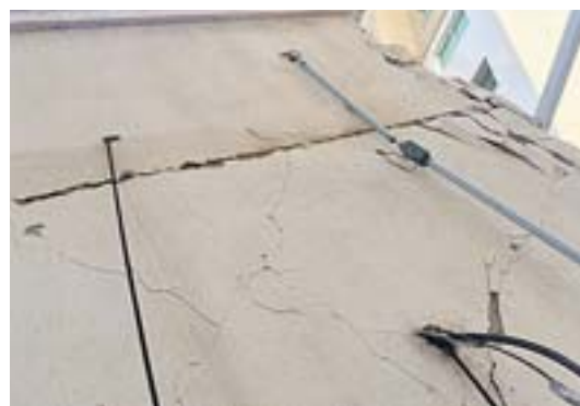
O LAUDO apresentado pela MCA Tecnologia e Estruturas afirma que foram encontrados restos de materiais ainda da época da obra e também várias “gambiarras”, como passagens elétricas e tubos de instalações hidráulicas, com furos na estrutura na área onde ficavam a piscina e a academia.
