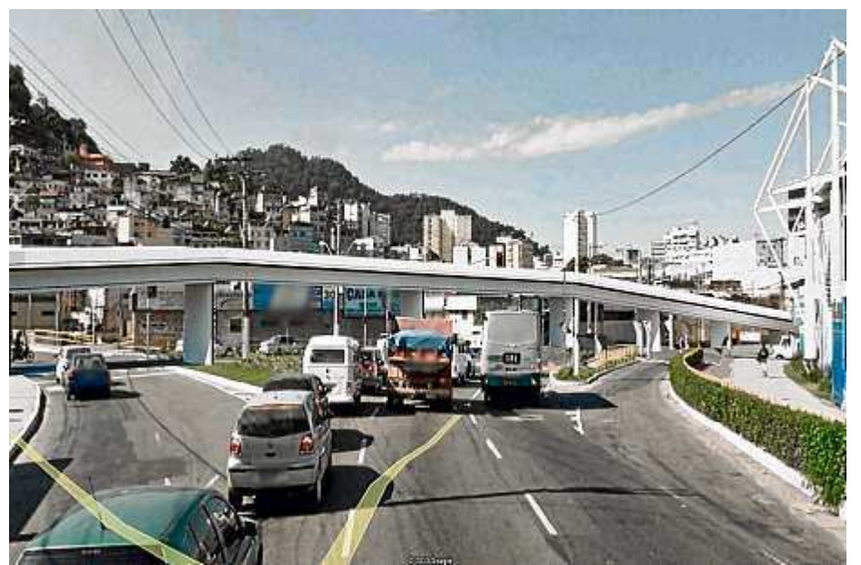
ESTRUTURA do viaduto, do Programa de Mobilidade Metropolitana, é de concreto, com extensão de 274 m
