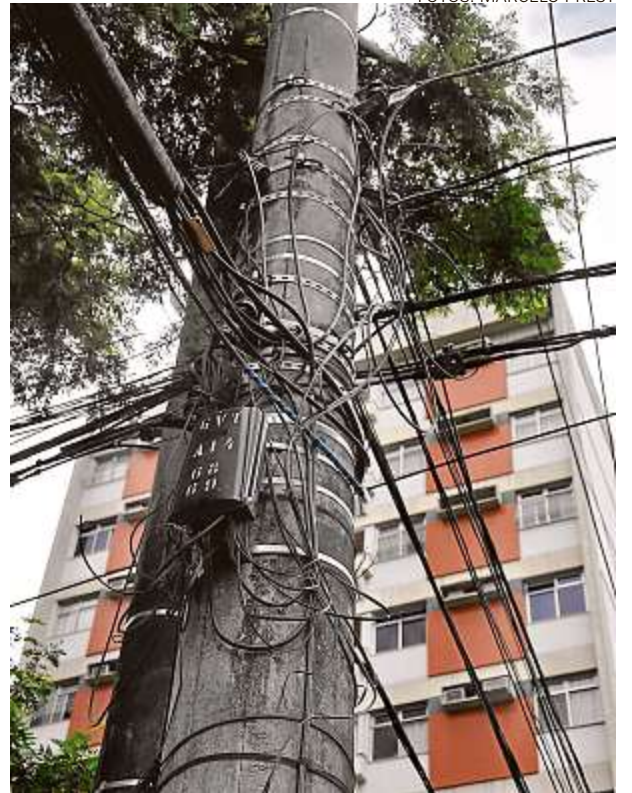
Fiações emboladas em esquina da Praia do Canto
