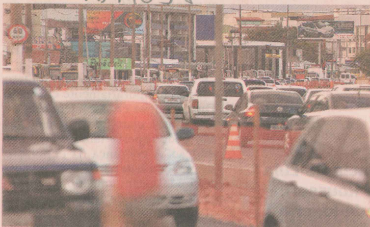
ATRASO. Em Camburi, o prazo para entrega da reforma da ponte, que era 15 de outubro, foi adiado para o dia 30 deste mês. FOTOS: EDSON CHAGAS
