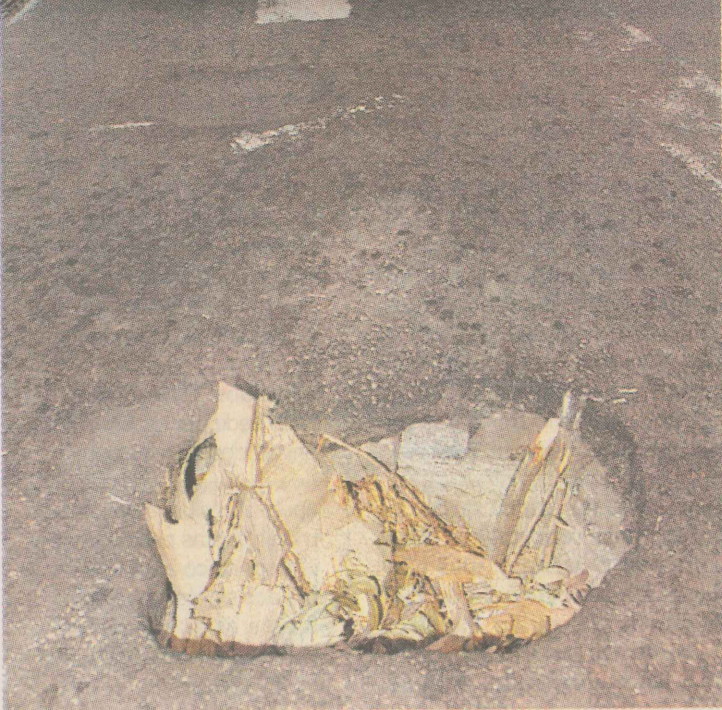
DESCASO. Um buraco de 30 centímetros de profundidade já danificou cinco carros, em Jardim Camburi, na Capital, no cruzamento das ruas Filogônio Motta e Fortunato Abreu Gagno. Para a prefeitura, a culpa é de uma empreiteira contratada pela Cesan, que não admitiu o problema, mas vai checar hoje. FOTO: EDSON CHAGAS
