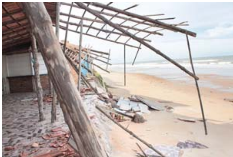
QUIOSQUE destruído pelo avanço do mar na Praia de Guaxindiba
