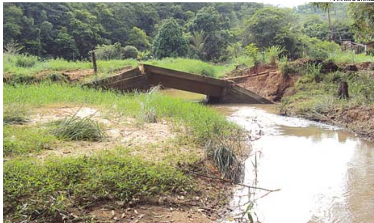
PONTE DESTRUÍDA na zona rural de Laranja da Terra. No município, 12 novas pontes vão ser construídas
