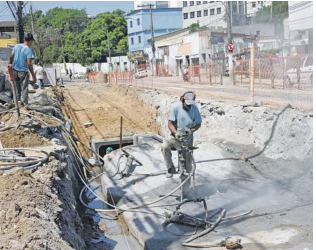
PEDRAS estão sendo retiradas na avenida Maruípe para instalação de galerias e redução de alagamentos
