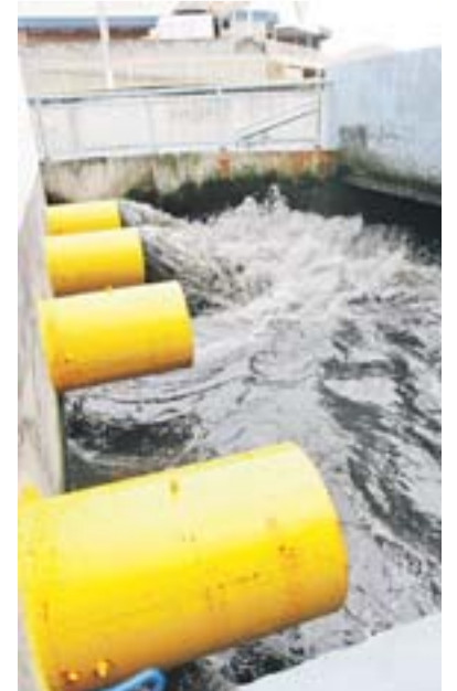
ESTAÇÃO bombeia água da chuva
