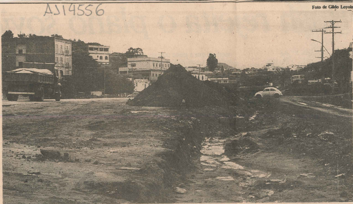
As obras na BR-262, no trecho entre Alto Lage e a Ceasa estão paralisadas por falta de recursos.
