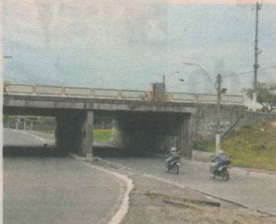
O VIADUTO GILSON FÉLIX, em Ilha do Príncipe, foi construído há 40 anos.
