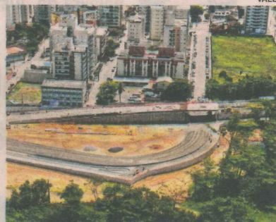
O VIADUTO DE CAMBURI, em frente à Vale, deve ficar pronto em dezembro.
