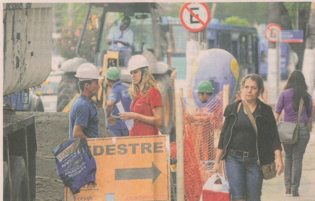
O JEITO É DESVIAR. Sem espaço, pedestres são obrigados a transitar próximo às obras
