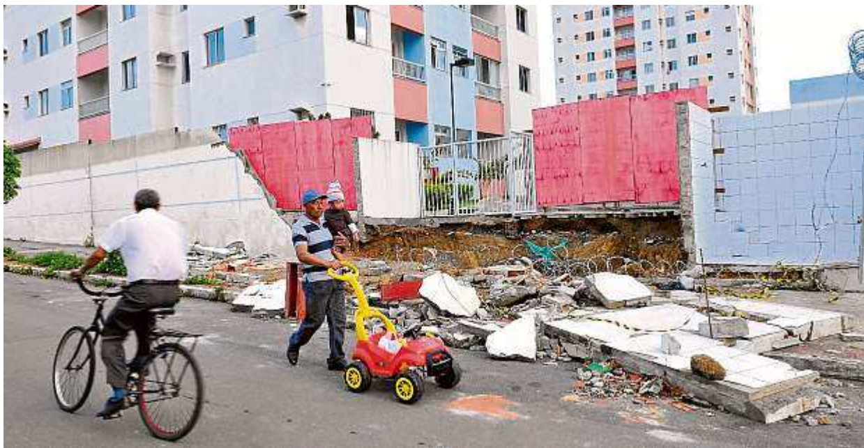
O prédio onde aconteceu o acidente iniciou os reparos no muro, mas ainda assim era possível ver os estragos
