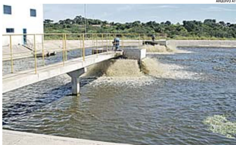
CENTRAL de Tratamento da Cesan: R$ 1 bilhão em saneamento
