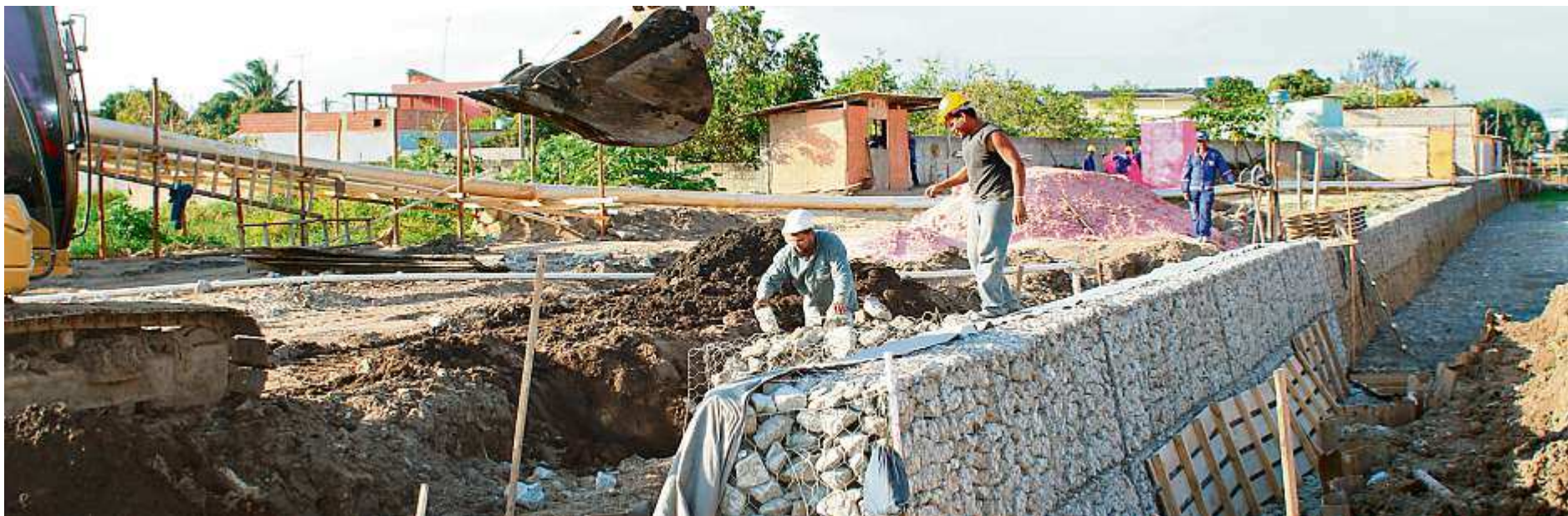
ESCOAMENTO. A abertura da foz do Canal da Costa é uma das obras em andamento na região que vão beneficiar cerca de 125 mil habitantes e, ainda, contam com aprofundamento do canal e construção de galerias
