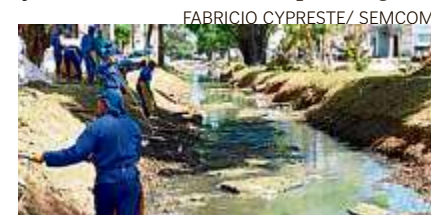
ALÍVIO. Estação de bombeamento de águas da chuva no local dará tranquilidade aos moradores
