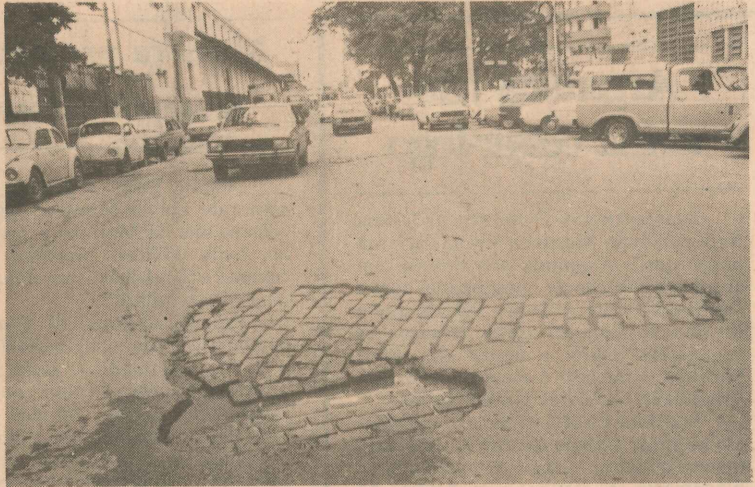
Este buraco já provocou acidentes
