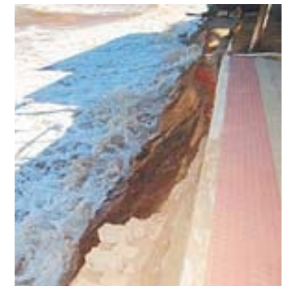
EROSÃO ameaça destruir calçada
