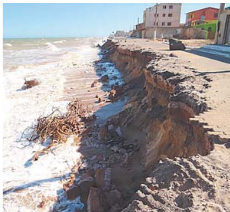
JAIR DOS SANTOS mostra os estragos provocados pelo avanço do mar
