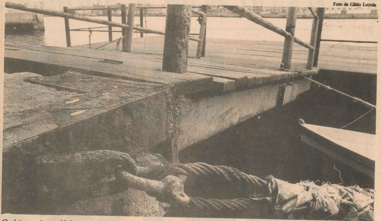
O sistema Aquaviário, que é deficitário, enfrenta também problemas de manutenção, como cabos corroídos
