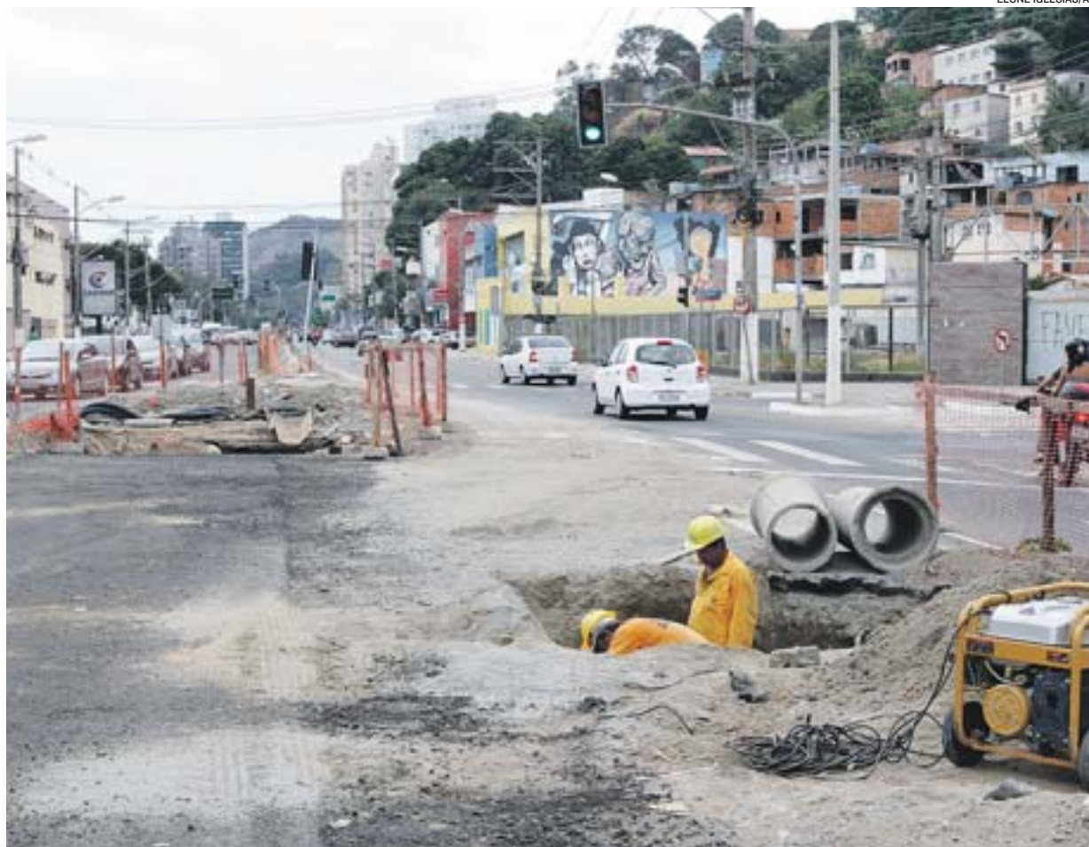
OPERÁRIOS trabalham nas obras de ampliação da avenida Leitão da Silva: DER agora é responsável pelo serviço
