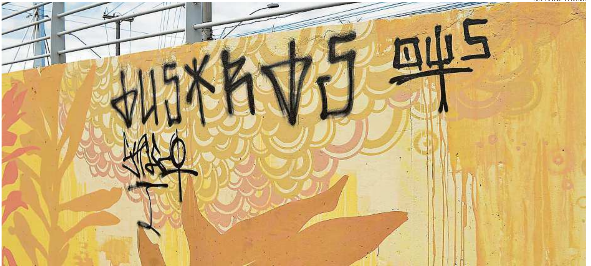
Rabiscos com spray de tinta preta foram feitos em cima da obra de grafite realizada pelo artista AQI Luciano na Ponte da Passagem, em Jardim da Penha
