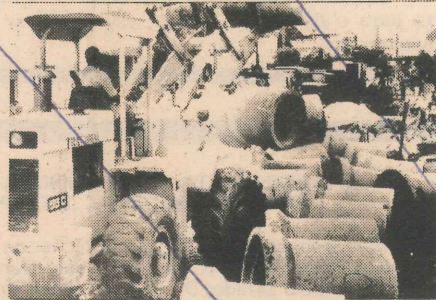
Máquinas e entulhos obstruem a avenida
