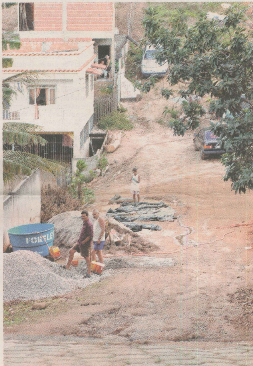
CHÃO BATIDO. O loteamento Manoel da Ilha é um dos pontos sem pavimentação nas ruas. FOTOS: CARLOS ALBERTO DA SILVA
