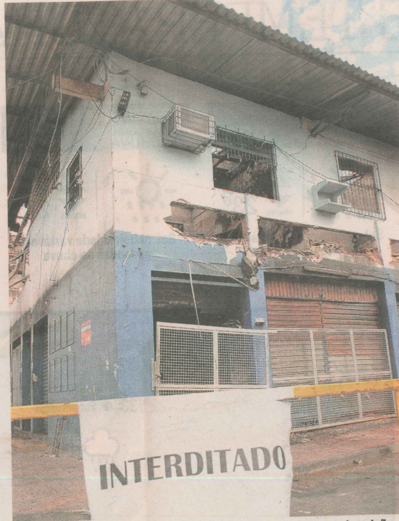
INCÊNDIO ocorrido no último sábado comprometeu estruturas do galpão
