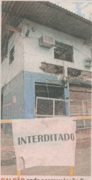
GALPÃO onde ocorreu incêndio
