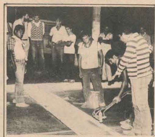
Com a aquisição de equipamentos próprios, o Detran tem possibilitado a renovação da sinalização horizontal. Na foto, vemos o diretor-geral do órgão, Lézio Sathler supervisionando os trabalhos.
