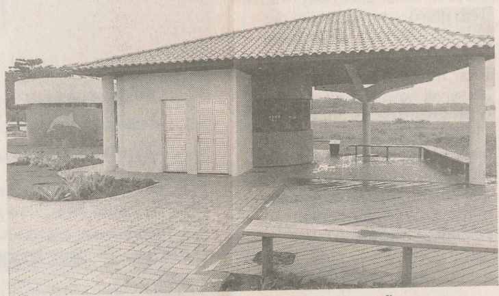
IRREGULAR. Quiosque não tem estrutura para ocupação. FOTO: GILDO LOYOLA
