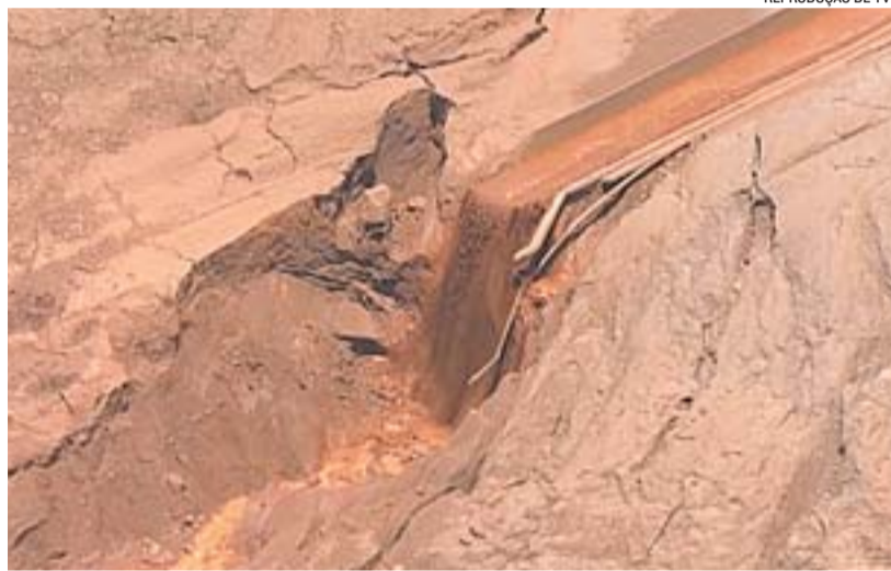
BARRAGEM DE SANTARÉM transbordou e tem risco de desmoronar
