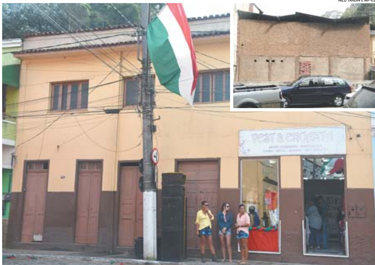
PARTES frontal e traseira do Casarão Bassetti em Santa Teresa. Imóvel foi “condenado parcialmente” pela Defesa Civil
