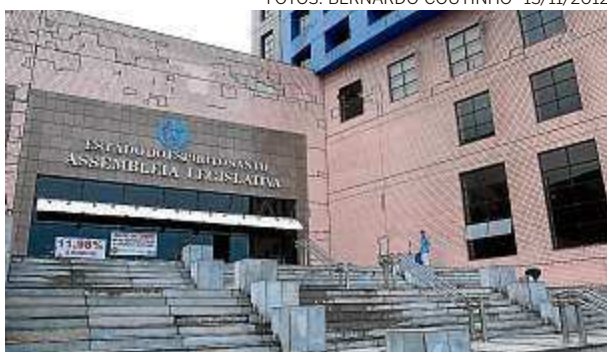
As pastilhas da fachada do prédio estavam caindo
