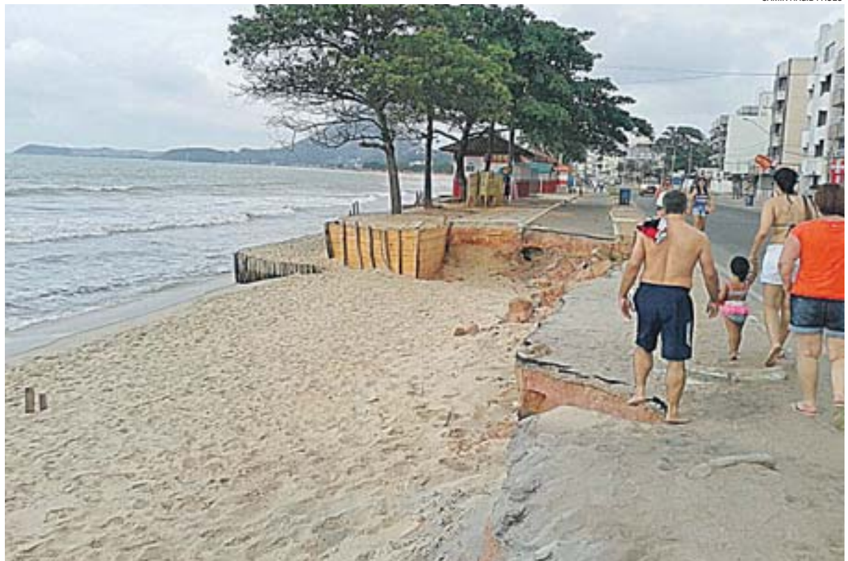
TRECHO do calçadão da praia de Piúma, que foi destruído pelas ondas levando risco para os pedestres
