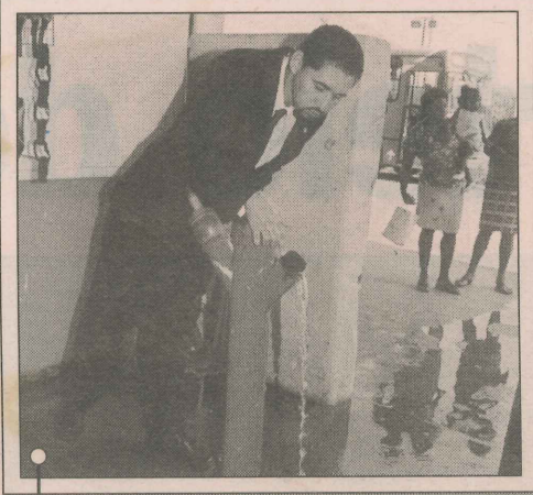
2. Durante a vistoria, o diretor da Ceturb flagra um hidrante destruído por vândalos no Terminal de Laranjeiras.
