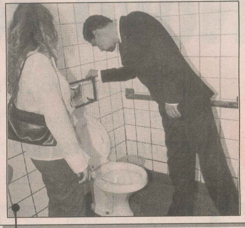
8 - A depredação nos banheiros é um dos maiores problemas apontados por Ferraz durante vistoria no Terminal do Ibes.
