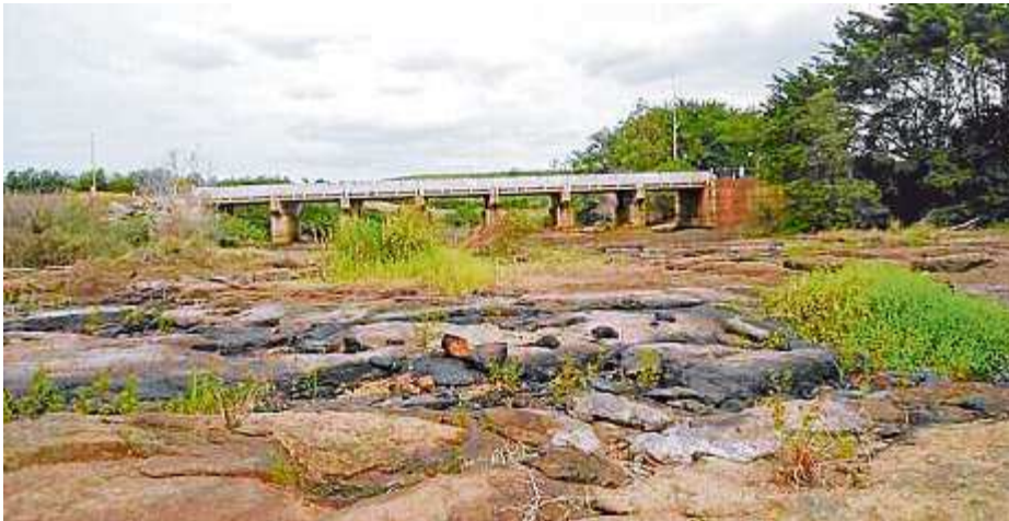
Embaixo da ponte, na região próximo a Rio Bananal, já não passa água
