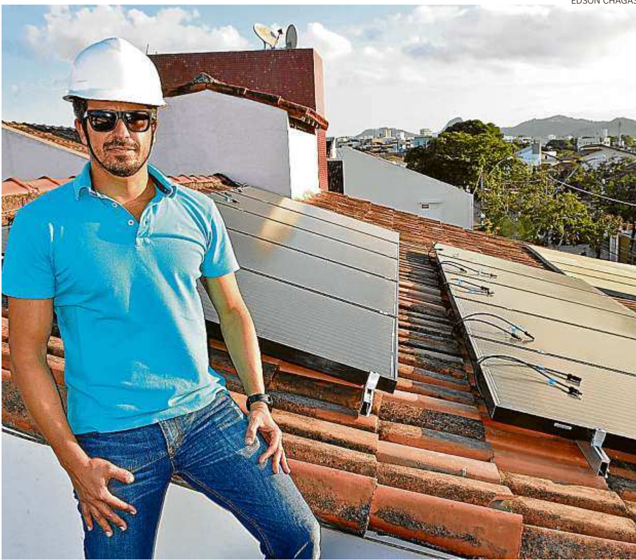
Engenheiro Gustavo Gravatá faz a instalação das placas: excedente de energia é jogado para a rede da Escelsa
