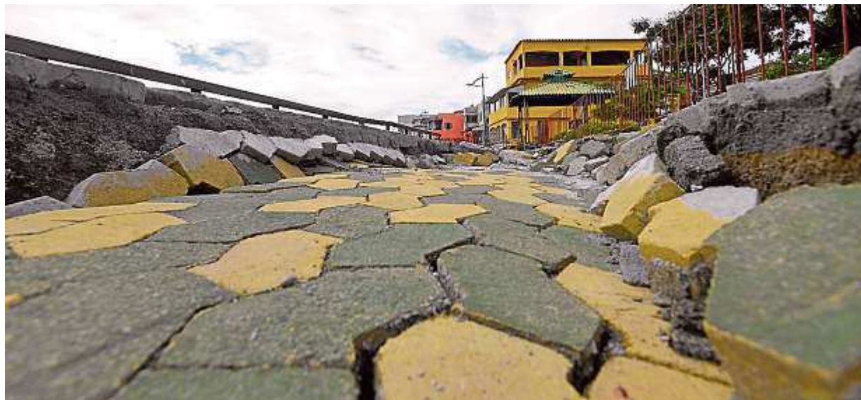
O calçamento da praça dos pescadores cedeu cerca de 10 centímetros e está sendo monitorado
