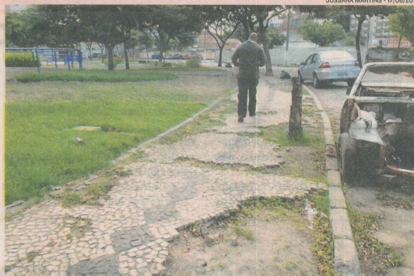
PRAÇA Oswaldo Guimarães, em Bento Ferreira: pavimento quebrado
