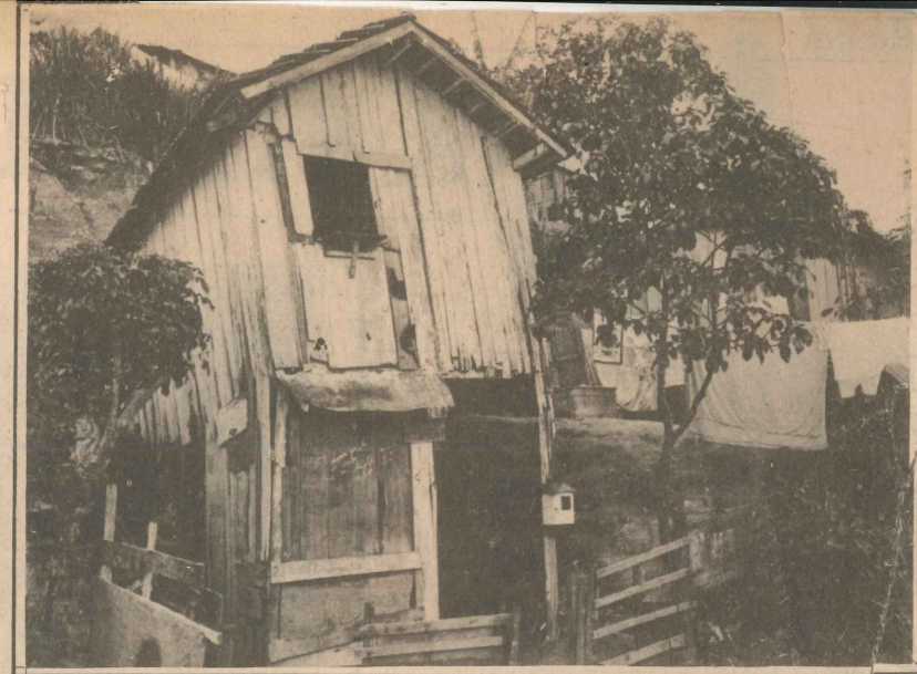
As últimas chuvas arrastaram esse barraco, refeito com tábuas de segunda mão, sem as mínimas condições de segurança.
