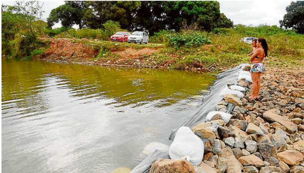
Reforço com plástico foi feito pela Cesan para tentar impedir que a água do Rio Jucu fosse para o mar
